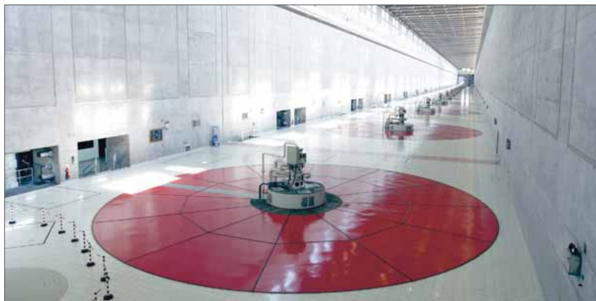
Casa de Força de Yacyretá: 20 unidades geradoras de 150 megawatts cada
